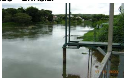
FOTOGRAFIA Nº 4. CONJUNTO MOTO-BOMBA – GUARAREMA – SÃO PAULO
